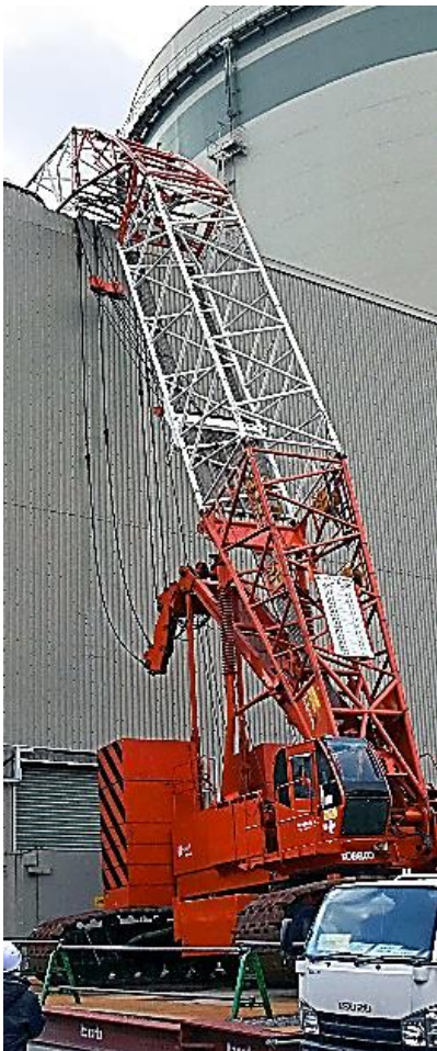
後ろの建屋は核燃料の貯蔵庫。台車の一方のキャタピラが浮き上がっているように見える。地盤沈下は確認できない。(朝日新聞)
